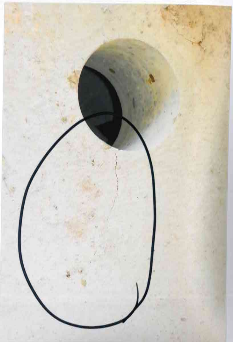
Zbliżenie długo liniowych pęknięć stropu żelbetowego.
