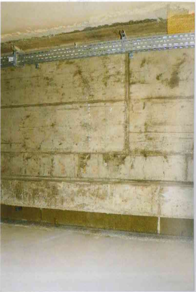
Zbliżenie niskiej jakości deskowania pod strop żelbetowy.
