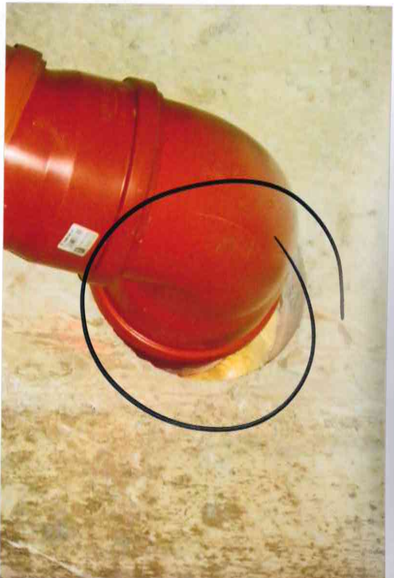
Przykłady nadmiernych przekuć na rury i przewody.
