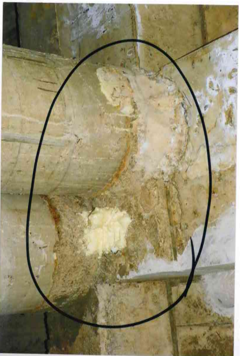
Zbliżenia wady wykonawczych słupów podporowych stropu nad podbaseniami.
